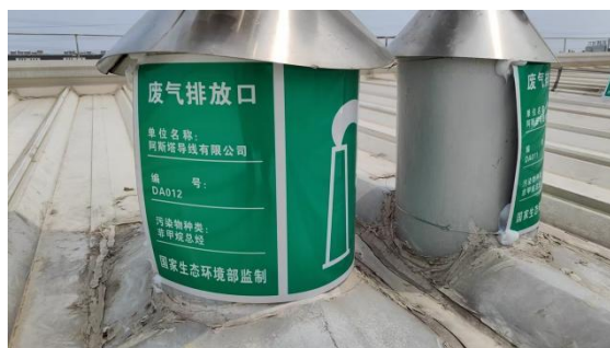
产品冷却废气 DA012 排口
