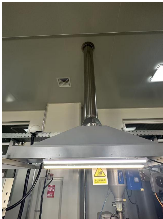
挤塑废气收集装置
