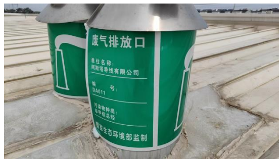
产品冷却废气 DA011 排口
