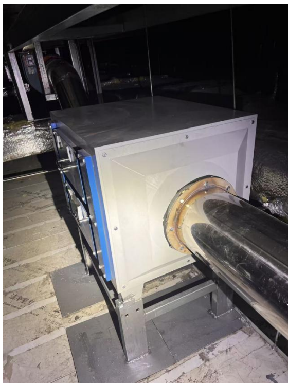
挤塑废气：二级活性炭装置
